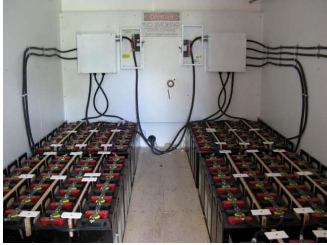
Şekil 40: Fotovoltaik Sistemdeki Enerjiyi Depo Eden Aküler
